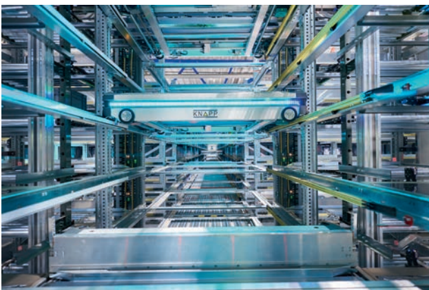
Das Evo Shuttle ermöglicht eine flexible und intelligente Lagerung von Kleinwaren und trägt mit einer Kommissionierleistung von 45 bis 50 Prozent der täglichen Aufträge entscheidend zur Effizienzsteigerung bei.
